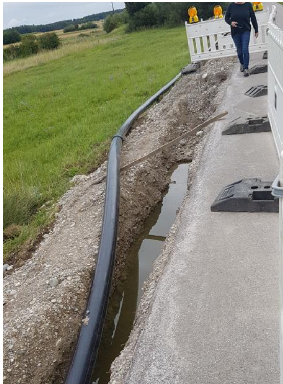
Abbildung 1: Verbundleitung zwischen Hattenhofen und Mammendorf
