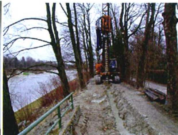
写真-3 ソイルミキシング工法による 施工状況 樹木を伐採しなくとも施工が可能である
