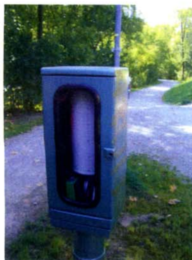
写真-13 堤防に設置された地下水位計 復元工事による影響を調べる ために事前に設置している
