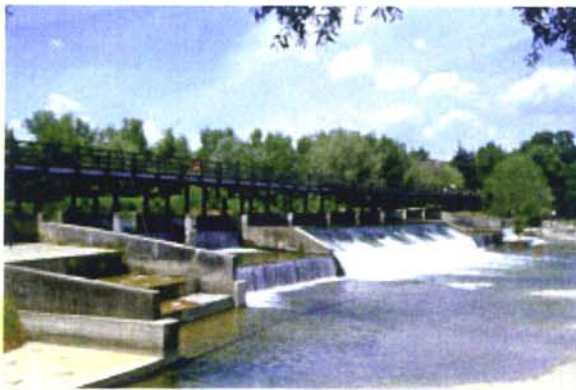
写真-5 施工前の落差工 魚類が遡上しにくい構造になっている
